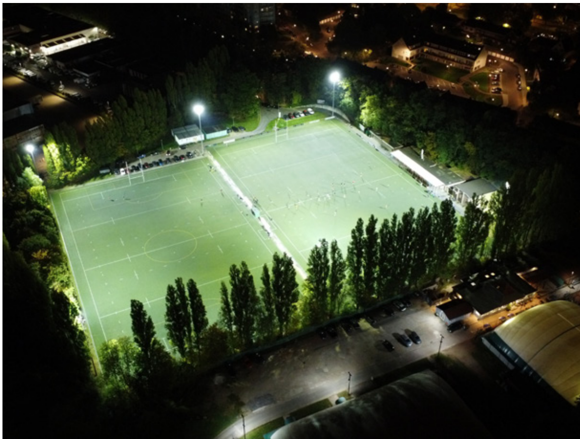
Le système d'éclairage du terrain Wahis, installé par la firme Lexar.
